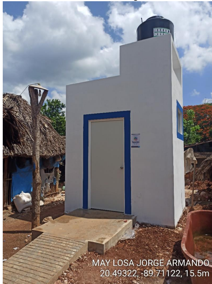
Sanitario con biodigestor
